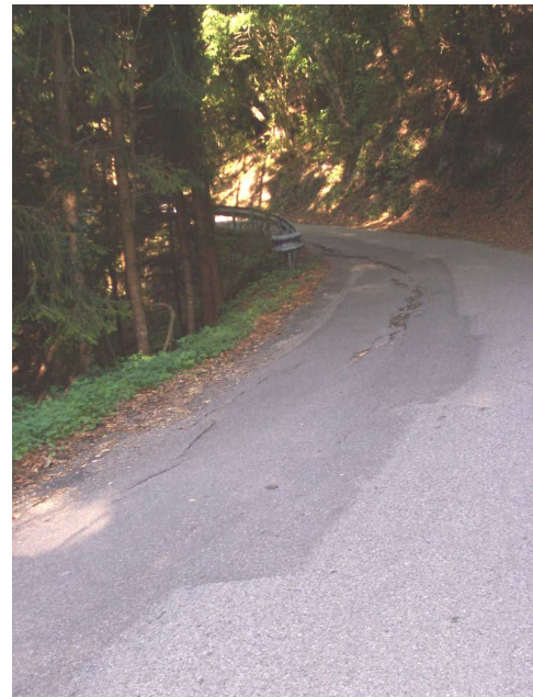
Figure n°6: Glissement de la route de Bourmeyer
