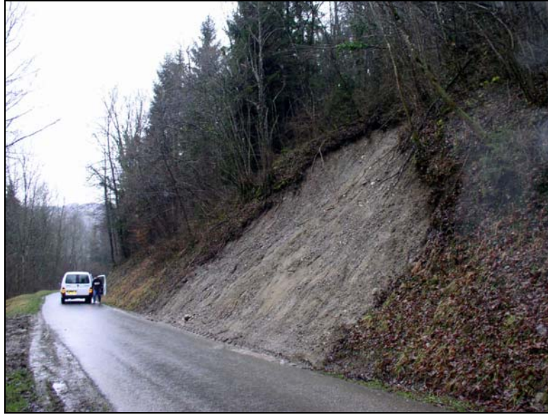
Figure 16 - Loupe de glissement le long de la D 164 (déblayée)
