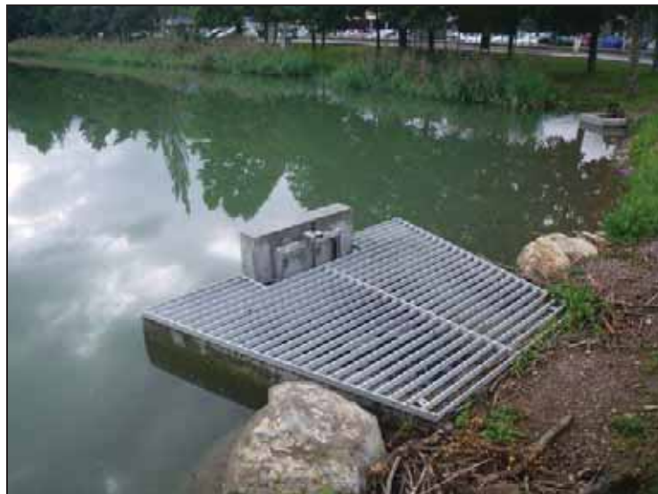
Ouvrage de régulation du Lac des Pêcheurs
