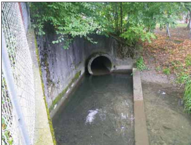
Ouvrage d'entonnement \varnothing 800 mm en amont du groupe scolaire
