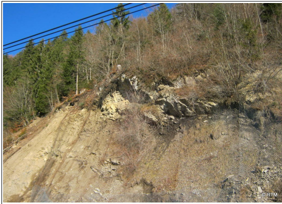
Photo n°2 : Eperon rocheux générant des chutes de blocs sur la RD42 et protégé par un filet – source RTM 74 – Janvier 2011
