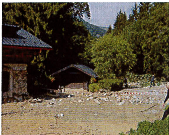
Boue sur les murs de l'habitation et du chalet garage, situés à cote du bâtiment des services techniques.
