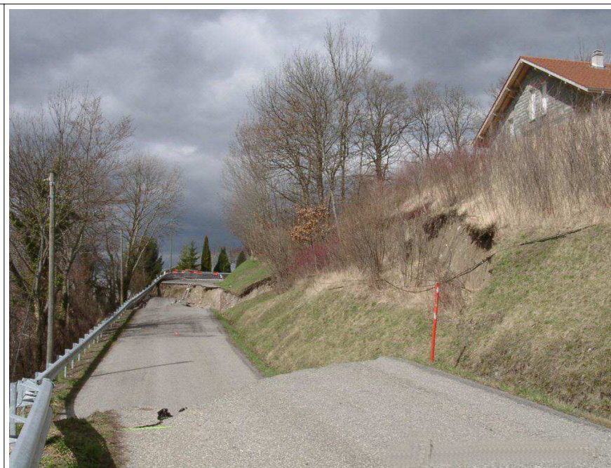
Photographie 6 – Fissure de tête du glissement de VOUGRON. Décrochement de 1,50 à 1,80 m affectant notamment la RD121 sur 60 m
