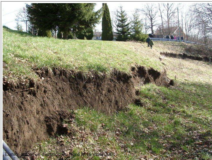
Photographie 5 – Niche d'arrachement sommitale du glissement de mars 2001 vers VOUGRON (dans sa partie nord-ouest)
