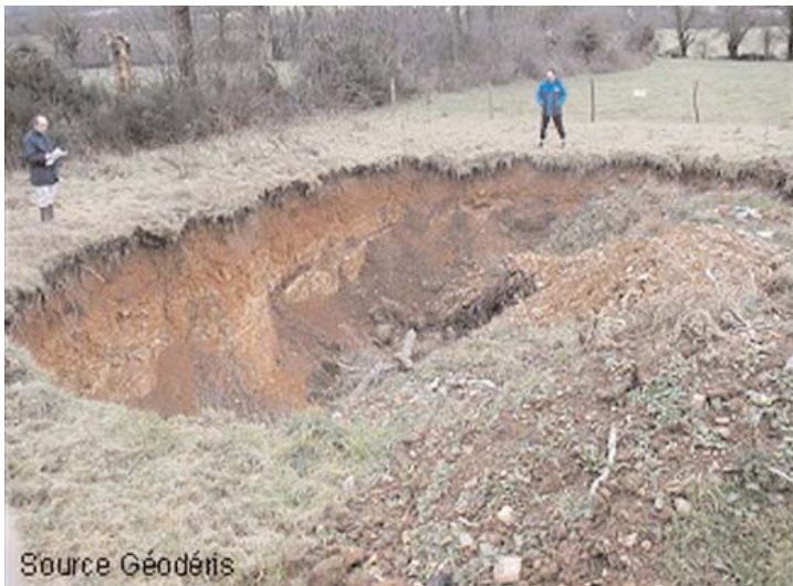
Photo 1 : Fontis en zone non urbaine
