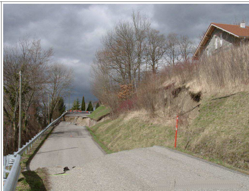
Photographie 6 – Fissure de tête du glissement de VOUGRON. Décrochement de 1,50 à 1,80 m affectant notamment la RD121 sur 60 m
