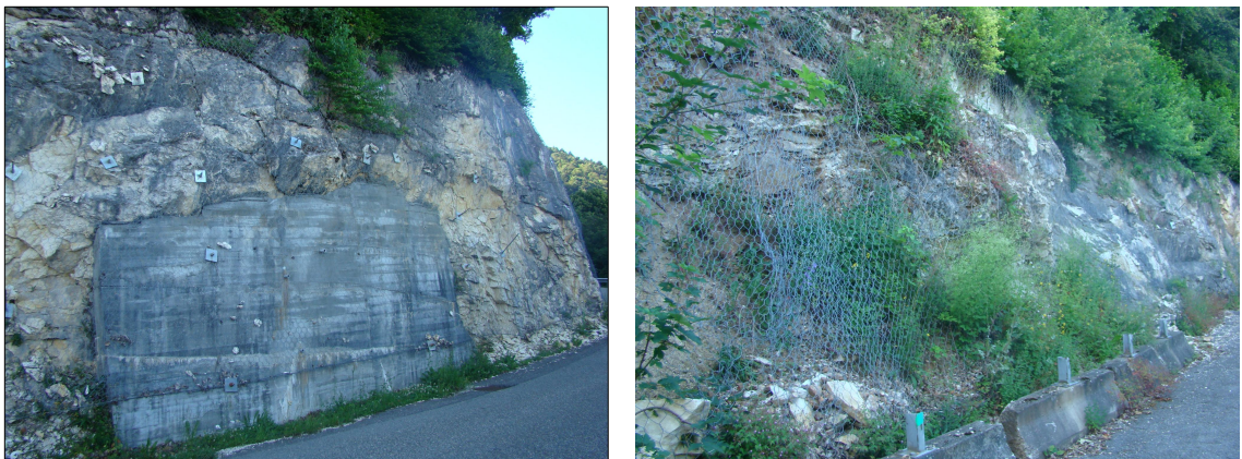
Fig. 16 : Confortement des escarpements le long de la RD 45, à COLLONGES-SOUS-SALÈVE [Source : IMS RN ]
