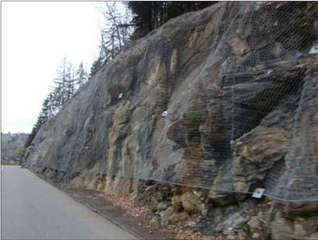
Fig. 20 : Grillages plaqués avec ancrages le long du talus rocheux amont de la RD 6, au niveau de la Croix Verte [Source : IMS RN ]
