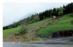
Glissement de terrain RD 909 - mai 2015
