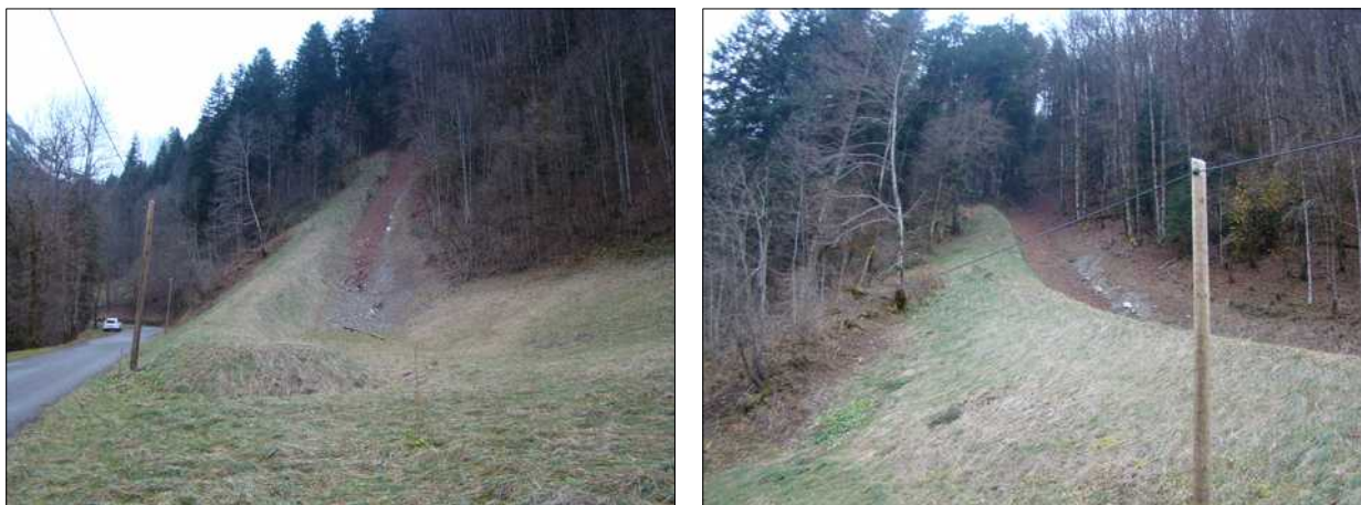
Fig. 27 : Tourne paravalanche en pied du couloir n° 11 de l'EPA, juste en amont des Pesets [Source : IMS RN ]
