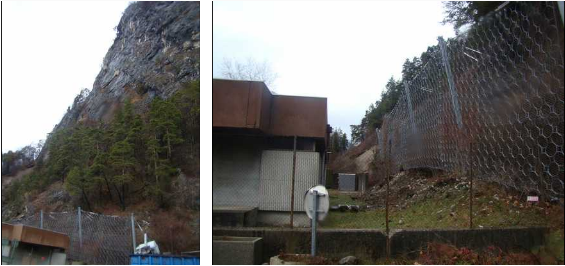
Fig. 29 : Filets ASM en bas de versant de la Roche de THÔNES, protégeant le poste électrique [Source : IMS RA ]
