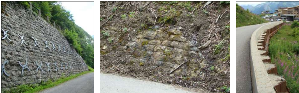
Fig. 26 : Exemples d'ouvrages de soutènement présents sur la commune de SAMOËNS (enrochements, avec ou sans renforts, et mur en palplanches) [Source : IMS RN ]
