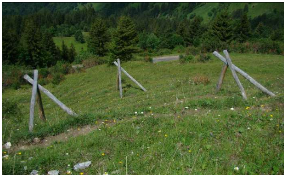
Fig. 22 : Tripodes paravalanches en amont de la RD 354 [Source : IMS RN ]
