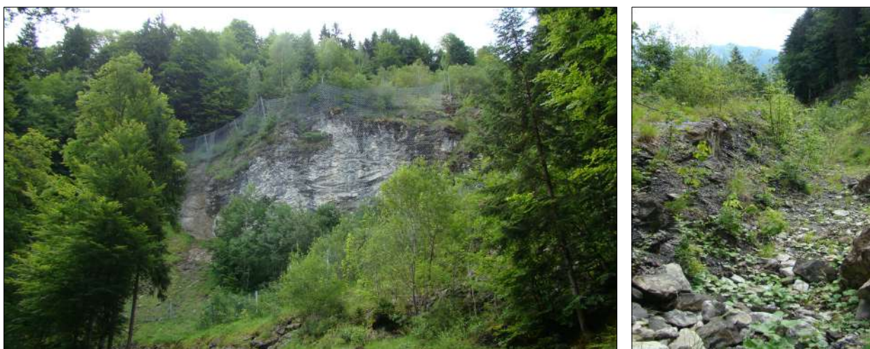
Fig. 25 : Dispositif pare-blocs le long de la RD 254, au Sud-Est de « Le Jourdi » (à droite : le piège à blocs) [Source : IMS RN ]
