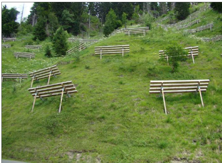
Fig. 23 : Claies paravalanches en amont de la RD 354 [Source : IMS RN ]
