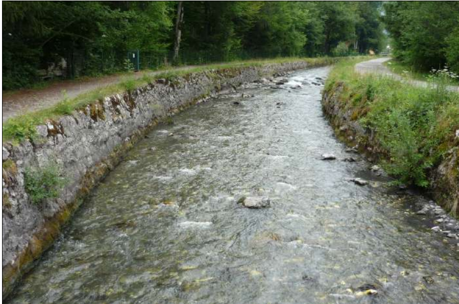
Fig. 20 : Protections de berge le long du Clévieux, en amont de la passerelle [Source : IMS RN ]
