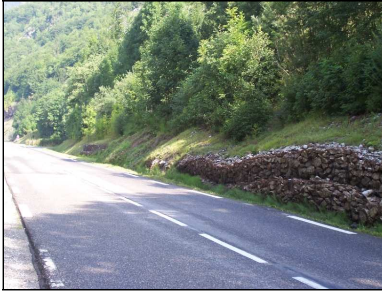
Photographie 10: Talus affecté par des glissements de terrain le long de la RD22 à l'entrée de la commune.
