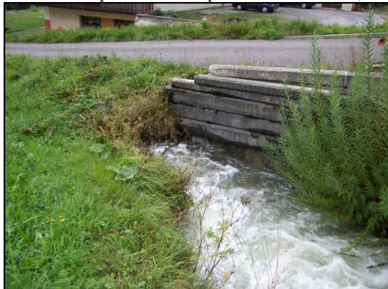
Photographie 6: Le ruisseau des Pécheux le 23 août 2005. La buse est en limite de débordement.
