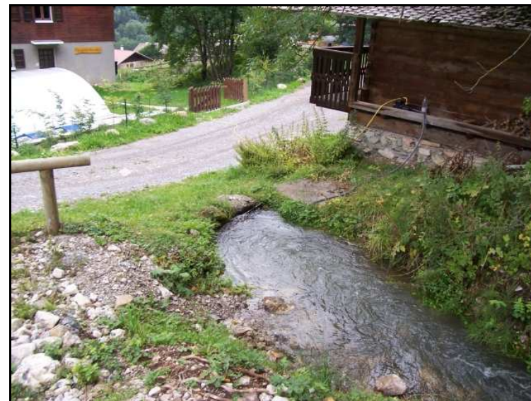
Photographie 7: Le torrent de RICHEBOURG, en limite de débordement à l'entrée de la buse le 23 août 2005.
