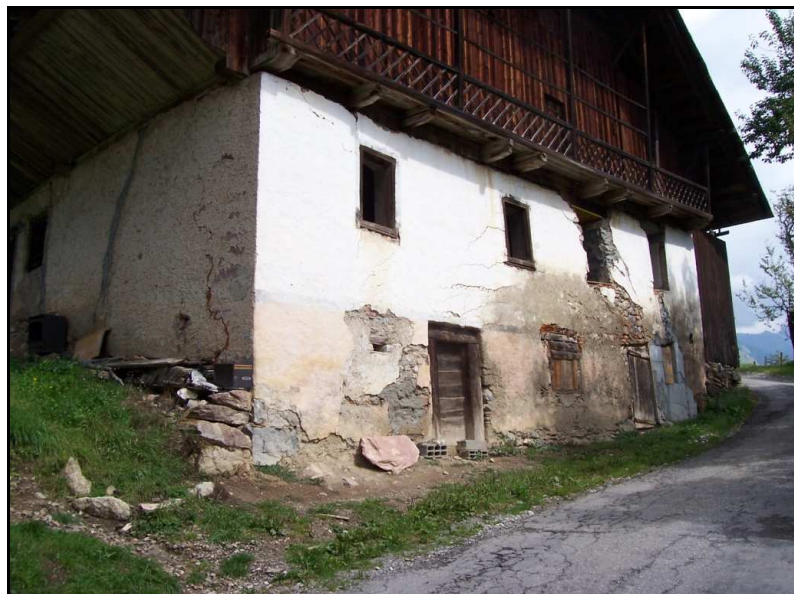
Photographie 12: Ancienne maison affectée par un glissement de terrain localisé, au hameau de FRÉMOUX-DESSOUS.
