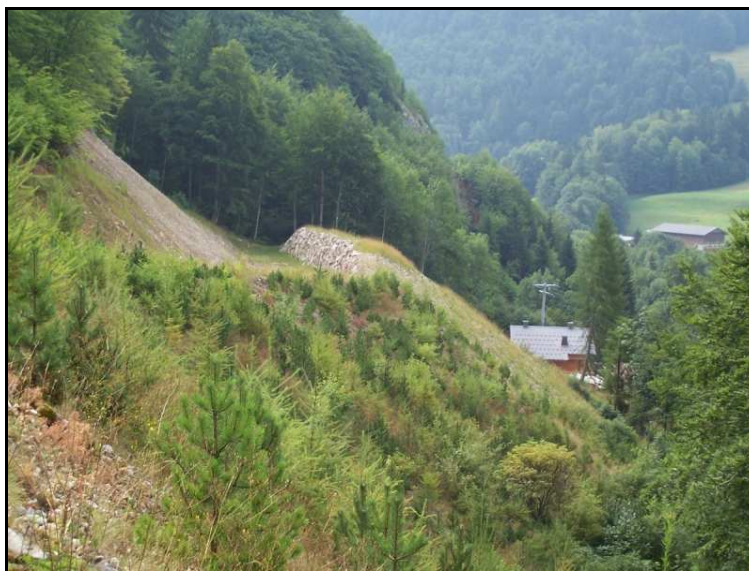
Photographie 9: Digue pare-blocs au lieu-dit « le Cercle ».
