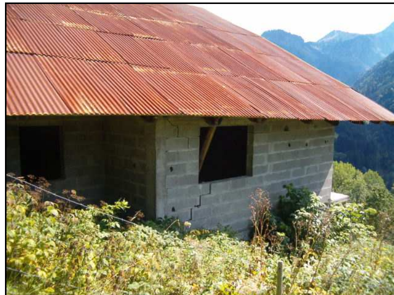
Photographie 11: Ancienne ferme en partie rénovée présentant des fissures importantes.
