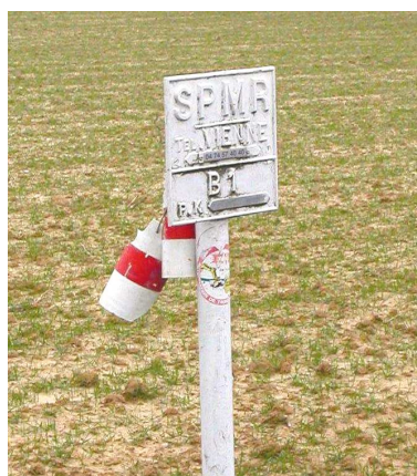
Borne de signalisation du Pipeline Méditerranée-Rhône
