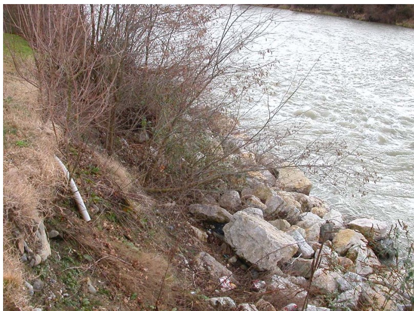
Annemasse-EG1 : L'Arve, en rive droite en amont du pont de la RD1206 – Effondrements localisés de berges par érosion.
