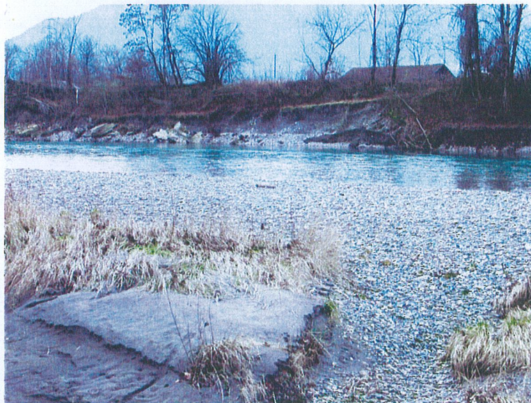
Arenthon-EG1 : Rivière de l'Arve au niveau de l'ancienne passerelle (Iles de la Barque) – Affaissements de berges en rive gauche.
