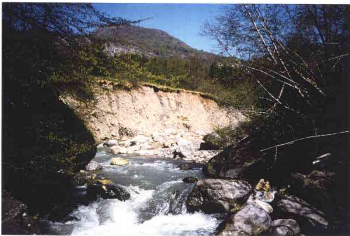
Photo 4 : Affouillemnt des berges du Risse (aval du Chef lieu).
