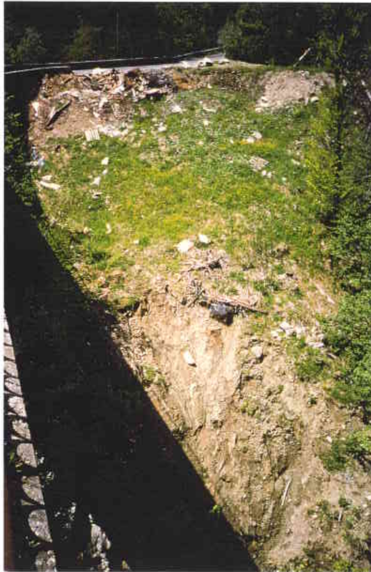
Photo 11 : Instabilité de terrain par surcharge de matériaux (Pont de la Tourne).
