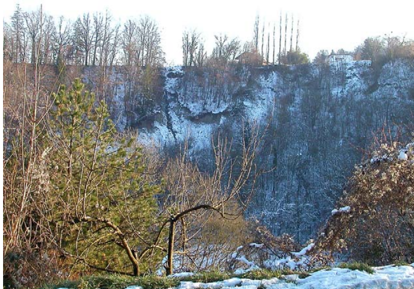
Reignier-EGT1 : Torrent du Vaison, en rive droite, sous Césarge – Affaissement de talus et ravinements.
