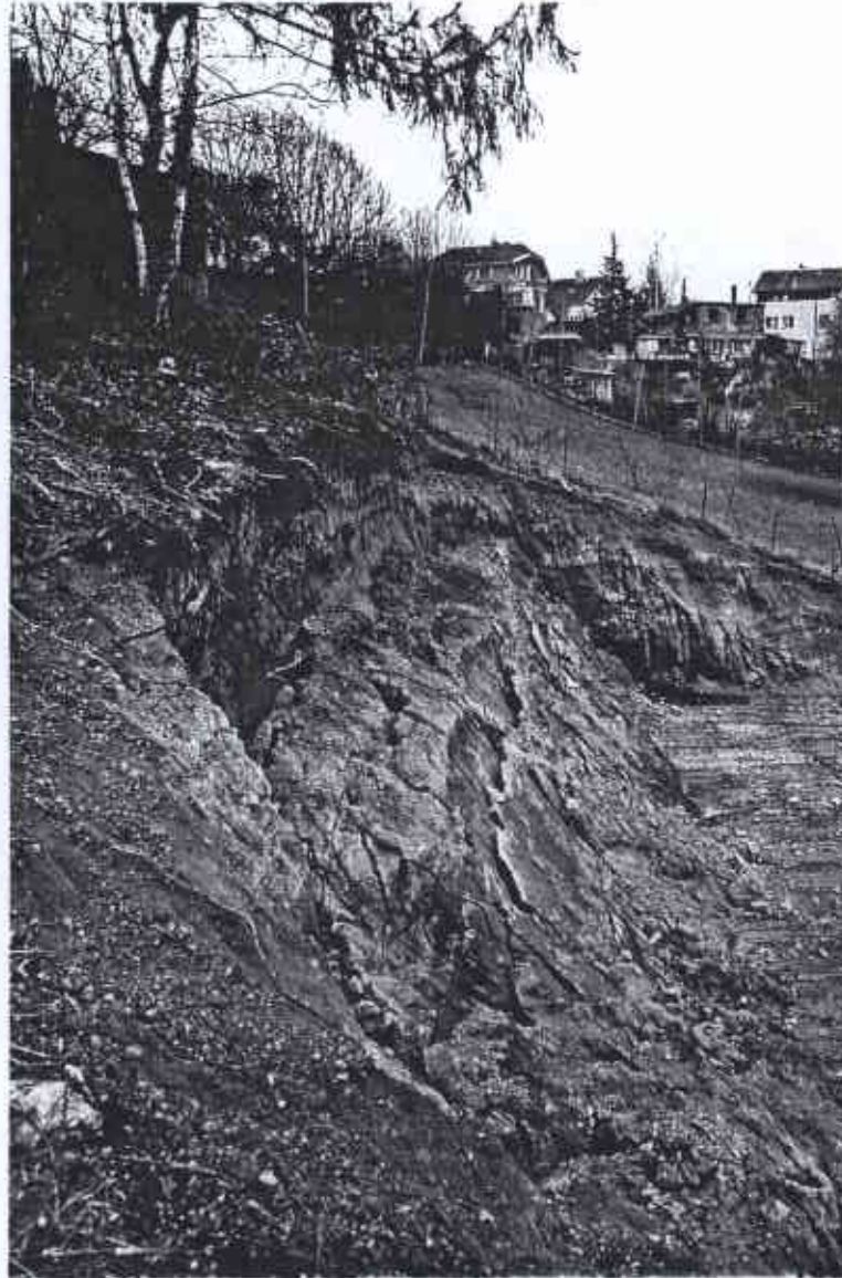
Glissement de talus aux Vignes du Châtelet : l'aléa faible de glissement de terrain (zone 11) indique que des fouilles faites sans précautions (fruit trop raide et sans soutènement) peuvent occasionner des problèmes, mais que la stabilité générale des terrains reste correcte (ce mouvement local n'a pas déstabilisé les masses alentour) - photo RTM 74, 25/03/1998
