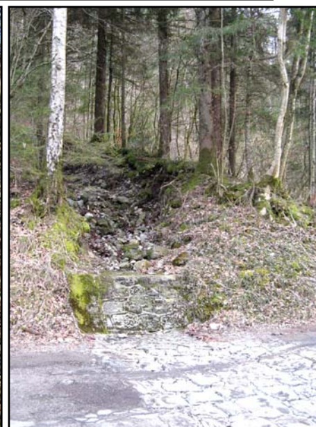
Raux-05 : Ruisseau du Lételet Passage à gué sur la route
