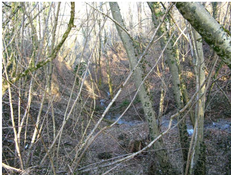
Etercy-EGT1 : Sous Syan, au niveau de la RD38 – Thalweg déstabilisé sur les pentes (affouillement de berges, accumulation de branchages).
