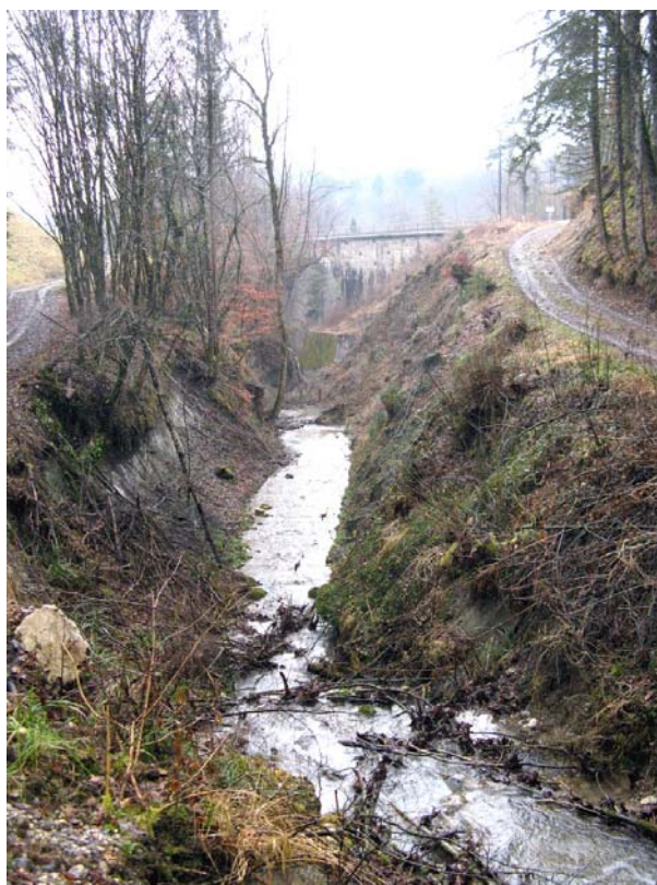
Etercy-EGT2 : Nant des Frasses, au dessus de la voie ferrée – Affouillement et érosion de berges actifs.
