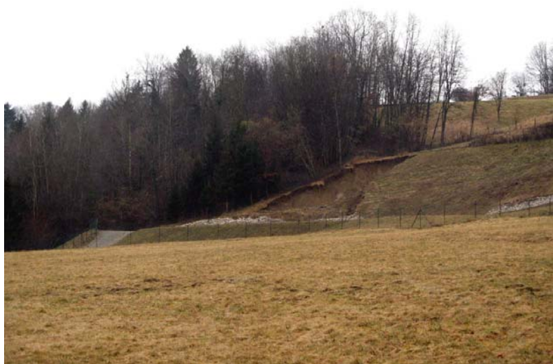
Etercy-EG2 : STEP au bord de la voie ferrée – Glissements récents et actifs sur le talus en amont.
