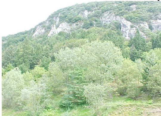
La falaise est un secteur de risque important en raison de chutes de gros blocs.
