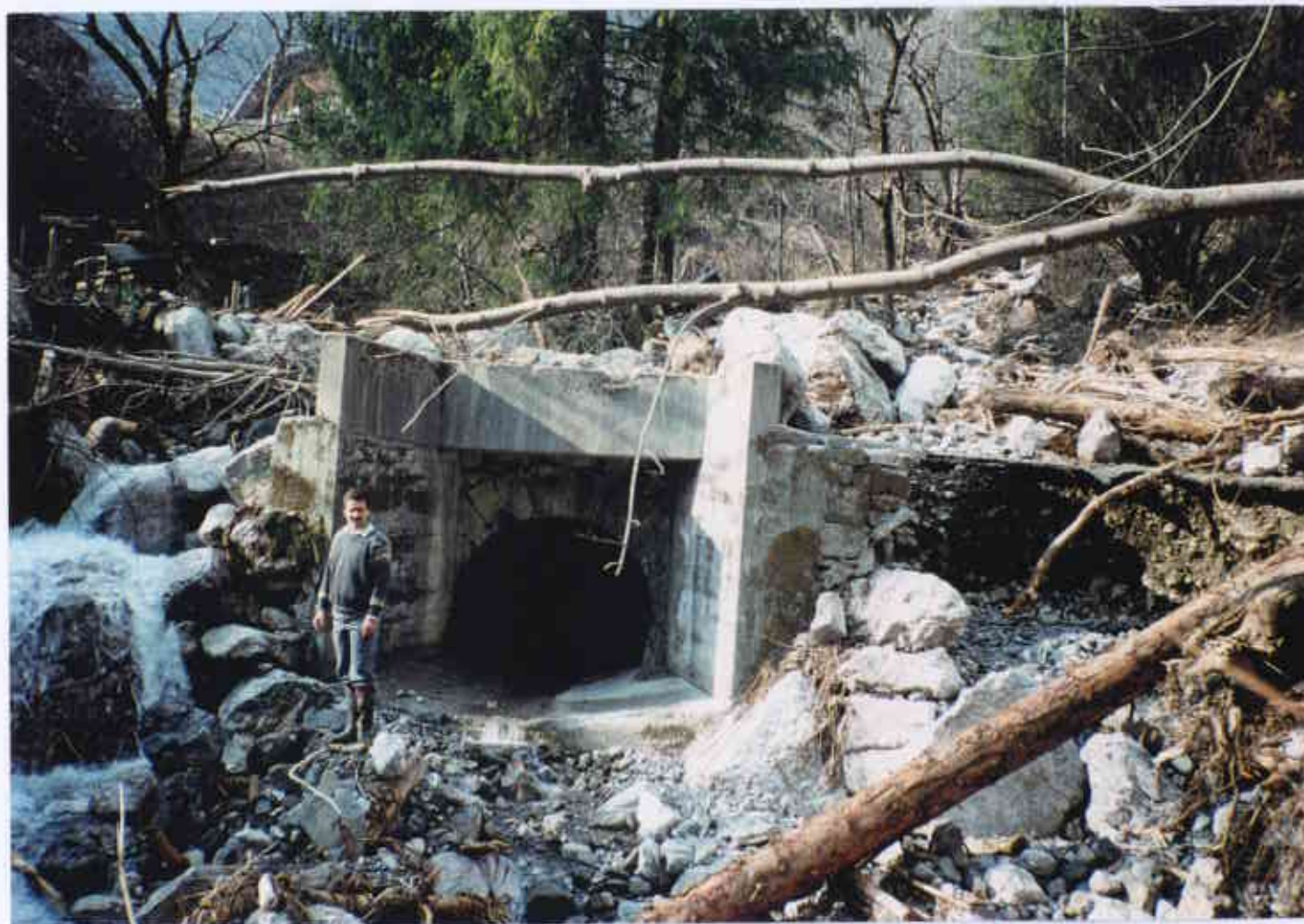
- Photo n° 19 : en février 1990, les fortes précipitations ont entraîné le débordement du Nant de la Ville et le dépôt de matériaux sur le pont de l'ancienne route départementale (zone n° 150) -
