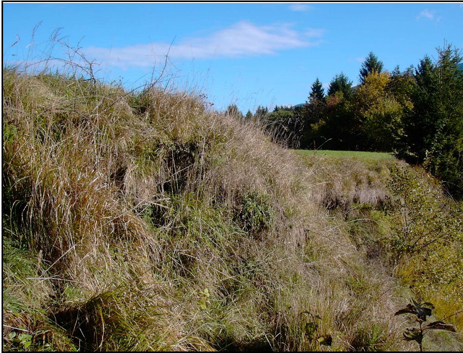
Niche d'arrachement d'un glissement de terrain vers "Chez Gaillard"
