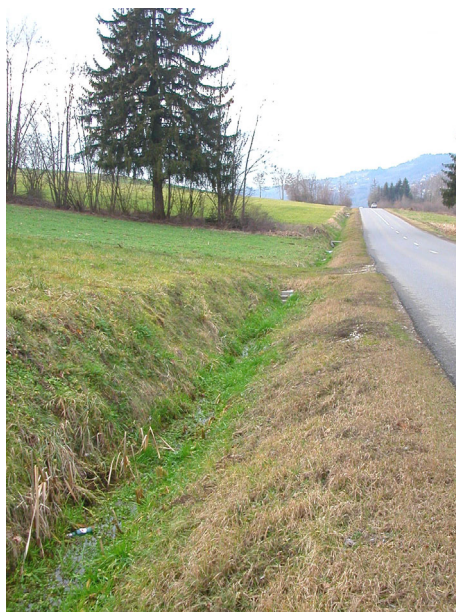
Marcellaz-OI1 : Larges fossés le long des routes permettant de collecter les eaux de ruissellement (comme, par exemple le long de la RD9).
