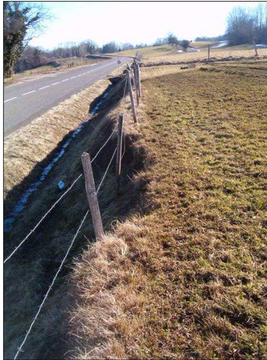
Photo 8 : instabilités du talus de la RD32
