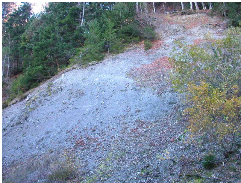
Nancy-EGP2 : RD119, Brion - Zone de glissement de talus : ravinement actif et déstabilisation progressive par le haut.
