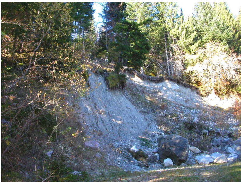
Nancy-EGP1 : Route forestière des Ferlets – Ancienne carrière présentant des signes de ravinement et de déstabilisation de talus.
