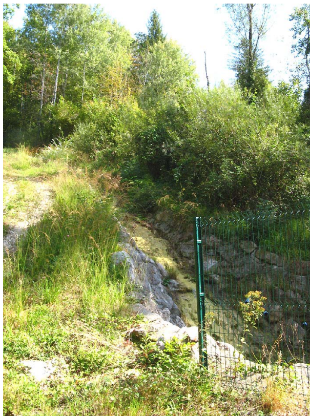
Naves-OGH2 : RD5, en amont du pont du Fier – Collecteur des eaux issues de la zone humide et petit bassin de retenue pour protéger la route.
