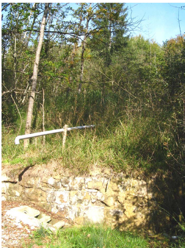
Naves-OGH1 : RD5, juste en amont du pont du Fier – Drainage de la zone humide située au-dessus de la RD.
