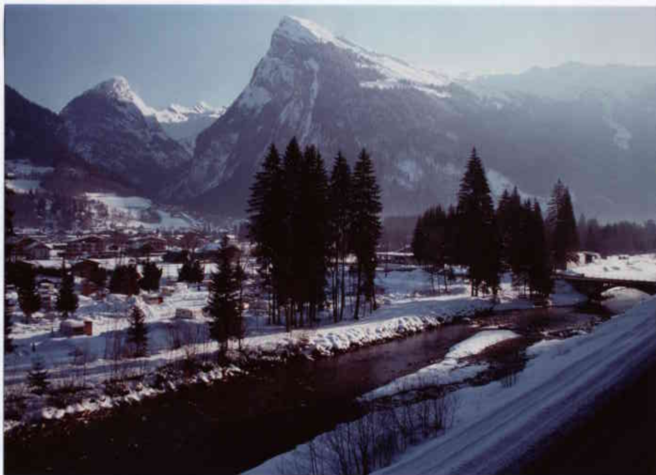
Le Giffre en aval du pont de Samöens - En rive D, vieille digue maçonnée plus ou moins endommagée par les crues, protégeant le camping-caravaning du Lac aux Dames.
