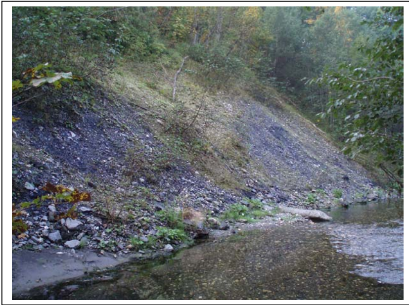
Photo n° 10 : Zone d'affouillement des berges, en rive gauche de l'Arly au niveau de l'Entreprise de travaux publics.
