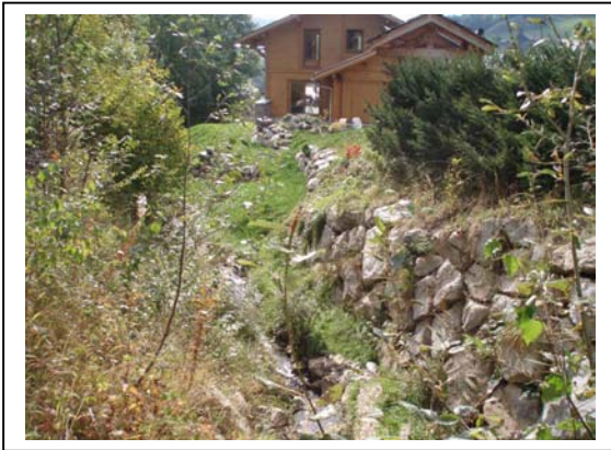
PRA-05 : Enrochement des berges du torrent des Essertets au niveau du lotissement
