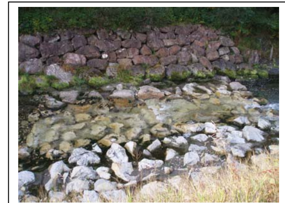
PRA-07 : Seuil dans le lit de l'Arly au niveau de la station d'épuration
