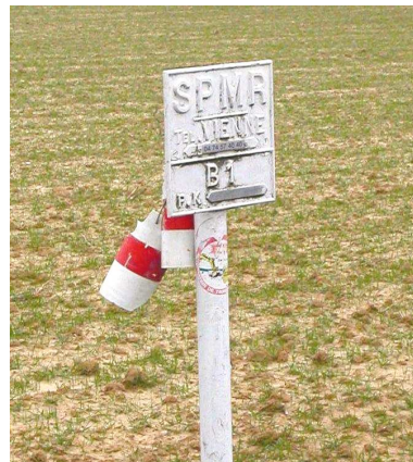
Borne de signalisation du Pipeline Méditerranée-Rhône
