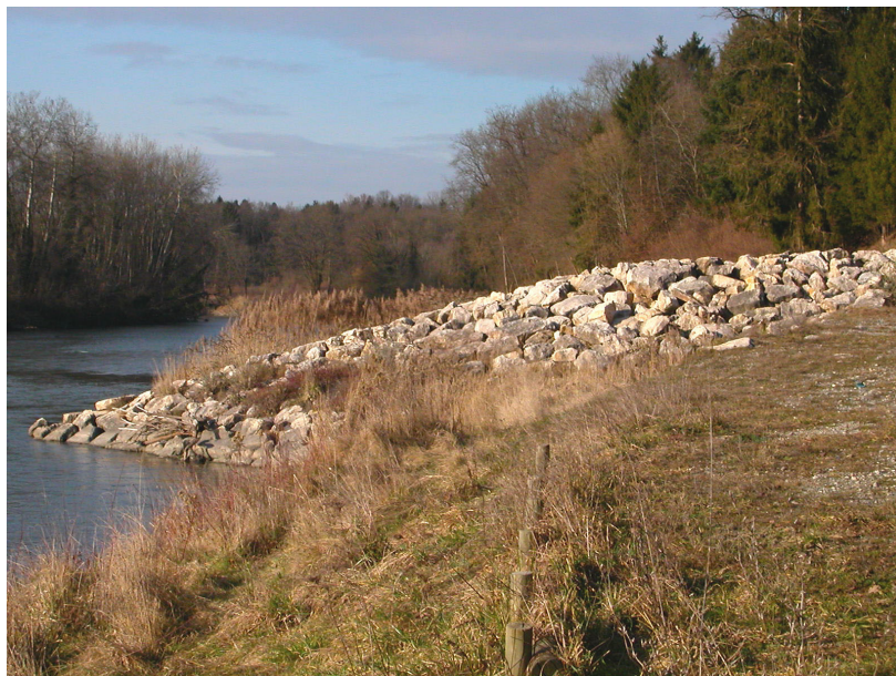
Contamine-OTG1 : L'Arve en rive droite, La Tuillière – Seuil latéral en épi par enrochements.
