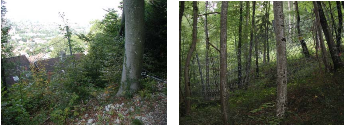
Figure 9- Eboulements et chutes de blocs - filets protecteurs- au lieu-dit « le Petit Port » au dessus du lotissement « les Barattes » à Annecy-le-Vieux
