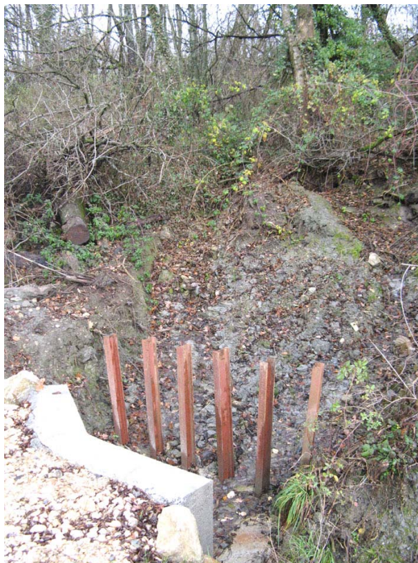
Crempigny-OT2 : Thavanot, juste avant le réservoir – Grilles retenant feuilles et branchages avant le busage.
