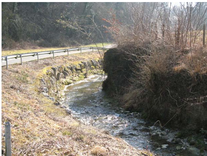
Menthonnex-OGT2 : Rivière de la Morge, en aval de la RD5 (en direction de Thusy) – Confortement de berges par enrochements.
