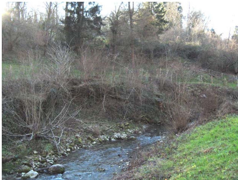
Menthonnex-EGT1 : Rivière de la Morge, en aval de la RD5 – Affouillement de berges et loupes de glissements.
