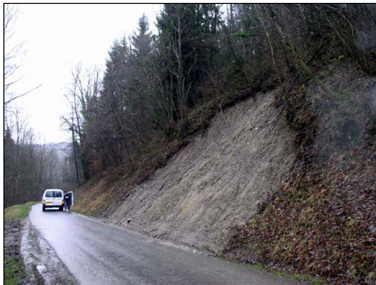
Figure 16 - Loupe de glissement le long de la D 164 (déblayée)
