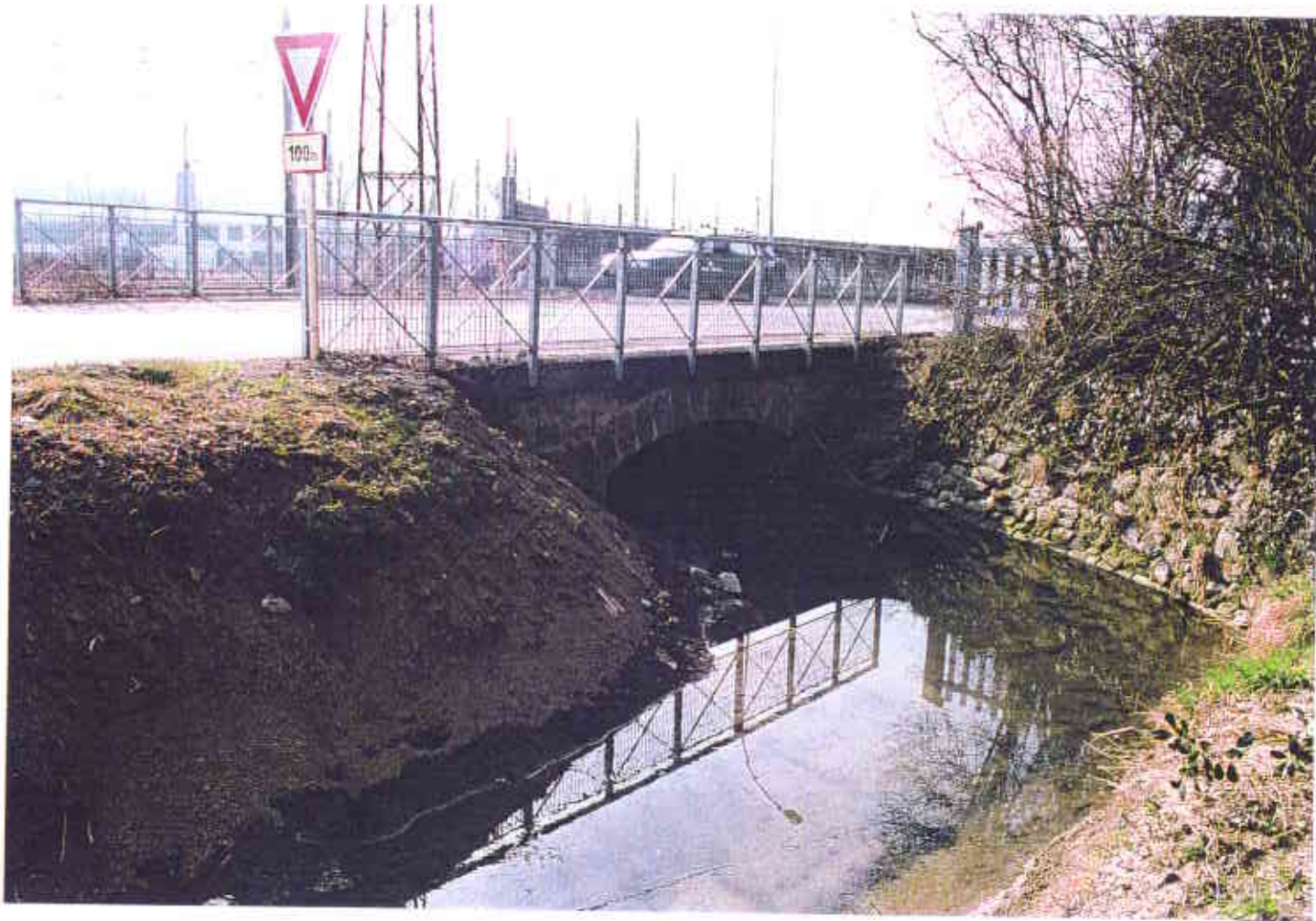
Commune de SAINT-JULIEN Passage de la route de Lathoy sur le ruisseau de l'Arande. Lors de crues du ruisseau, la section du pont est souvent à la limite de ses capacités.
