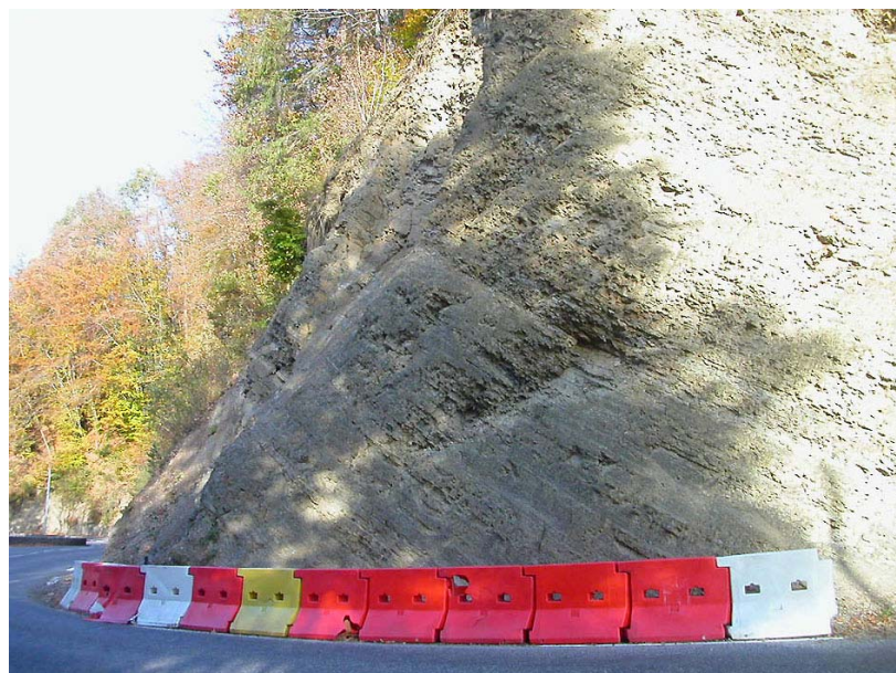
StPierre-EPG1 : RD12, à la bifurcation avec l'usine électrique – Talus très fracturés à l'origine de chutes de pierres sur la chaussée.
