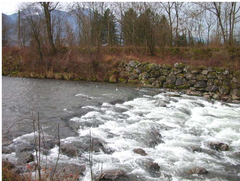
StPierre-OT2 : Le Borne, en amont de la confluence avec l'Arve – Confortement de digues et seuil par enrochements.
