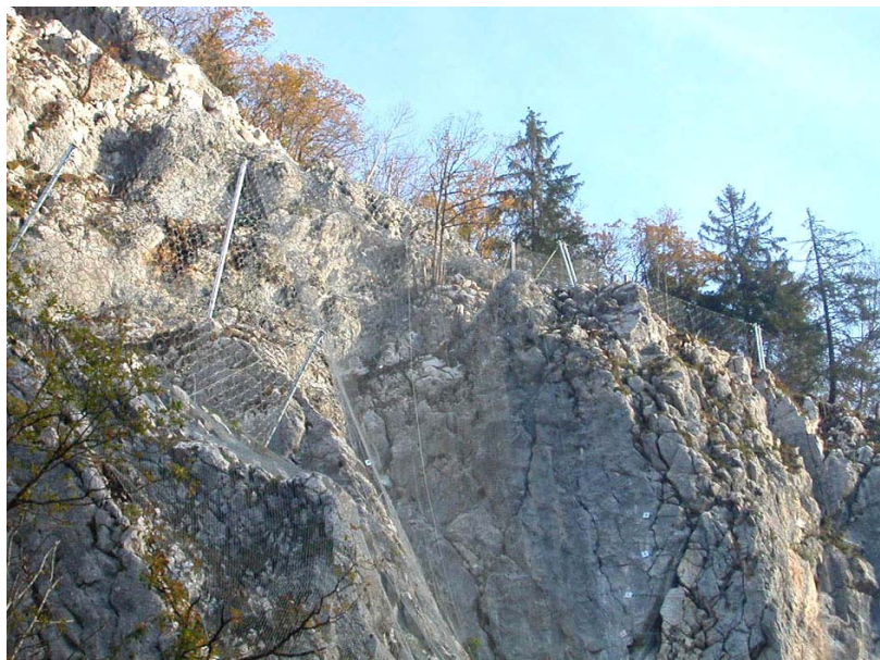
StPierre-OP1 : RD12, en limite de commune – Filets pareblocs, grillages, ancrages au niveau d'une zone fracturée.
